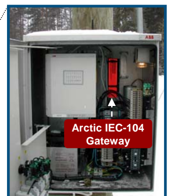
DTU 135 Control Cubicle
